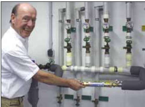
Alles klar! Das neue wartungsfreie Wasserbehandlungssystem AQUABION® ist installiert.
