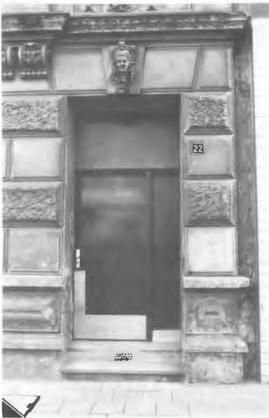
Die neue Tür verunstaltete den Eingang
