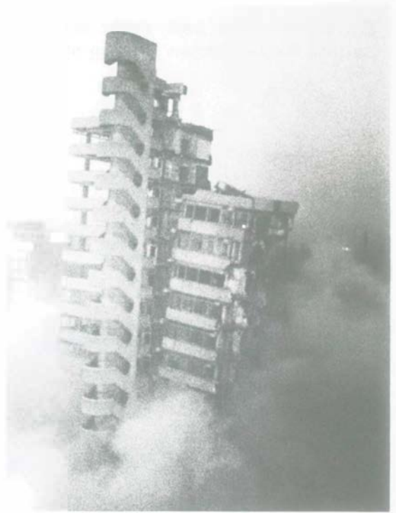
Ein Ereignis im Januar 1992: Düsseldorf hatte für zwei Tage einen „schiefen Turm“: Das asbestverseuchte Arag-Haus, eine städtebauliche Dominante am Mörsenbröcher Ei, wurde gesprengt. Doch ein schiefer Doppelturm blieb stehen. Den Rest besorgte die Eisenkugel.
